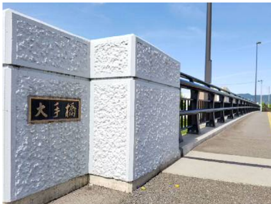
長岡駅東口より伸びる都市計画道路「台町川崎線」本線及び大手橋設計
